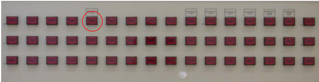
Slika 9 Svetlobni signal nas opozori na nevarnost prelitja v rezervoarju R_2
