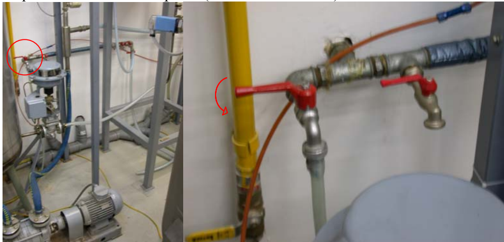
Slika 7 Pipa za dotok vode v črpalko
